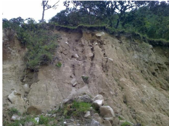
Procesos de borde de vía, en donde se ha desestabilizado el terreno y hay caída continua de rocas y prolifera la presencia de flujos geológicos en los periodos de lluvia intensa
